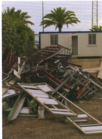
Fachada del pabellón desmantelada. Fotografía de Juanjo López de la Cruz y María González.
