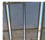
CELOSÍA. PASARELAS HORIZONTALES ANDAMIOS
